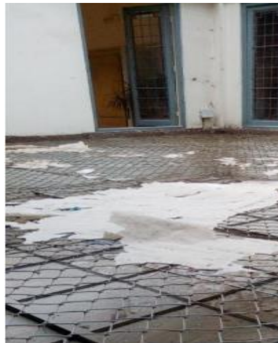
Fig. 5. Detalle de los restos deteriorados de la lámina plástica y de la red de protección metálica instalada posterior a la ejecución de la vidriera
