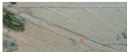
Fig. 31. Detalle de pieza de vidrio fuera del canal del plomo y de la suciedad de la superficie
